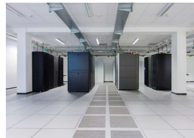
Figure 2 : Le mésocentre MUST depuis son installation dans la salle informatique de la Maison de la Mécatronique
