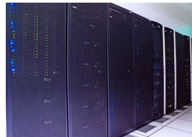
Figure 1 : Armoires hébergées au LAPP constituant le mésocentre MUST en 2012, année de la découverte du boson de Higgs
